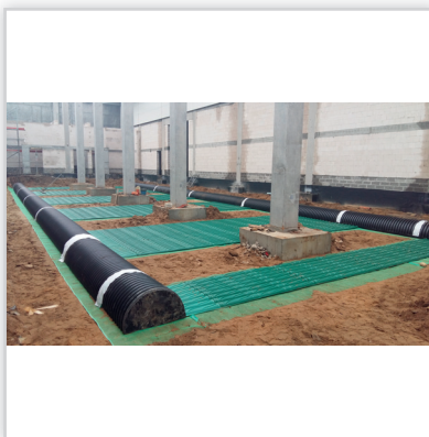
Gruntowy wymiennik ciepła GEOSTRONG – w fundamentach hali
